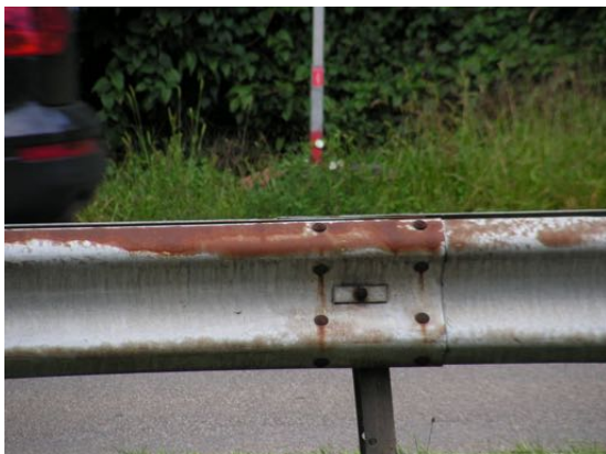
So sahen die verrosteten Leitplanken auf dem Zubringer bereits vor 7 Jahren aus.
