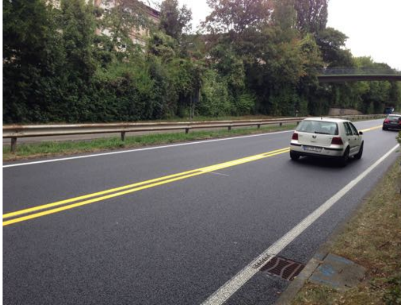
Der neue Fahrbahnbelag auf der B500 läßt den Gegensatz noch deutlicher hervortreten: Die alten verrosteten Mittelleitplanken müssen weg.
